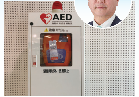
▲市役所に設置しているAED
