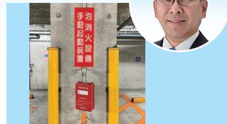
▲PFOSを含有していない泡消火設備
