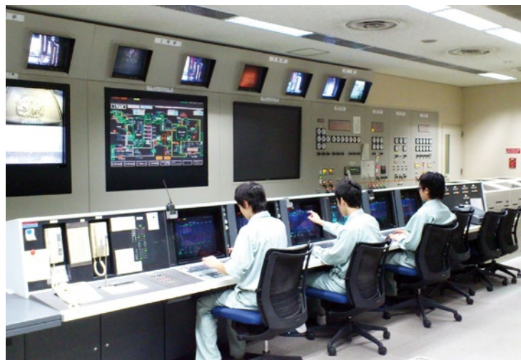
ちゅうおうせいぎょしつ 中央制御室 (施設内の全ての機械をここでコントロールしています)
