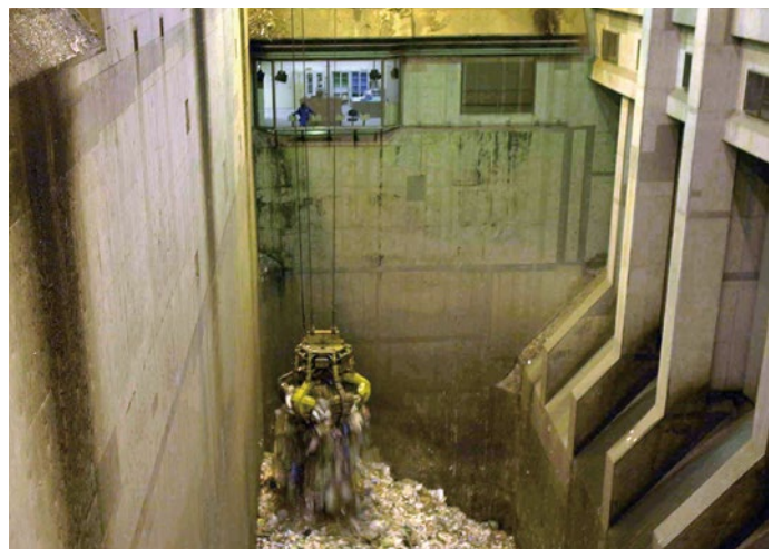
③ごみをクレーンでつかみ、焼却炉へ入れます
