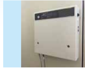
▲デマンド監視装置
