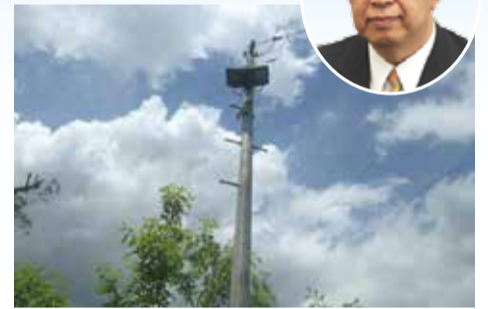
▲市道に設置しているLED照明灯
