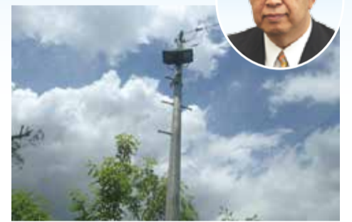
▲市道に設置しているLED照明灯
