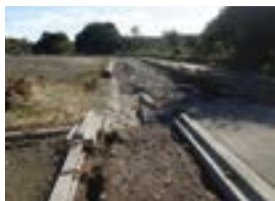
▲福生南公園の被害状況
