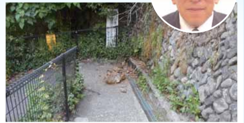
▲ほたる坂の落石の様子
