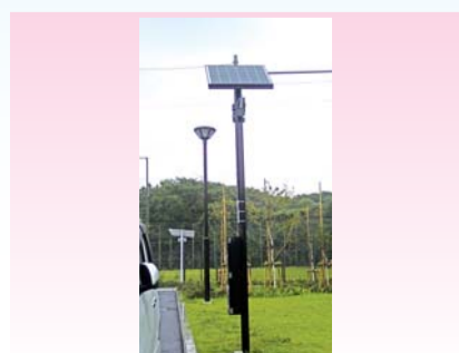
▲福生市防災食育センターに設置されているソーラー充電式LED照明灯
