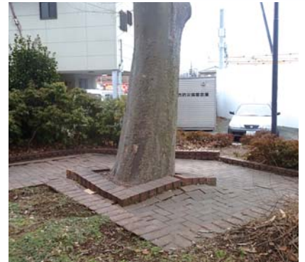
▲日光橋公園内の樹木根上りの様子
