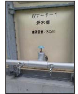
水栓が設置された受水槽
