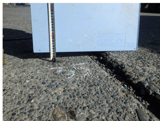
写真-6 路面の凹凸
