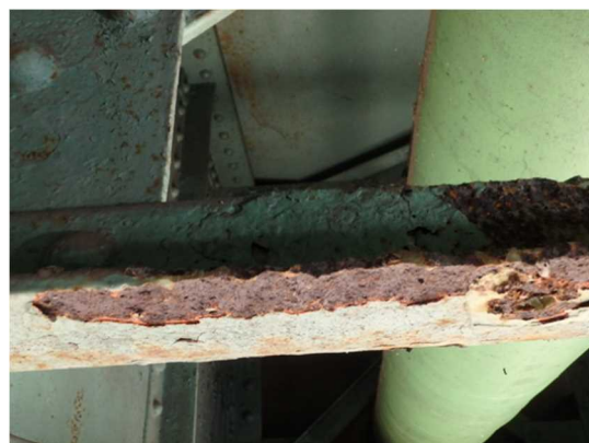
写真-4 対傾構の腐食
