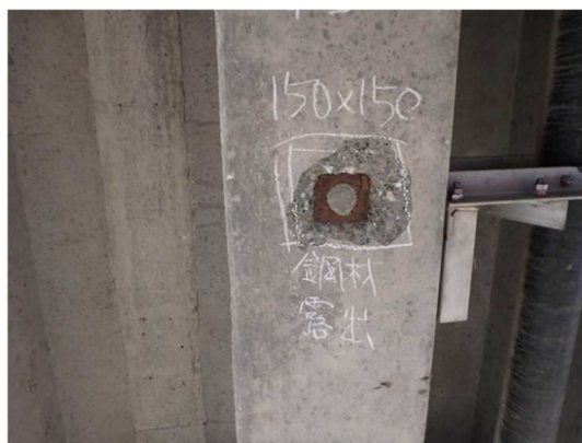
写真-1 主桁の剥離・鉄筋露出
