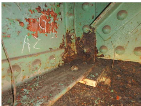
写真-3 主桁の腐食
