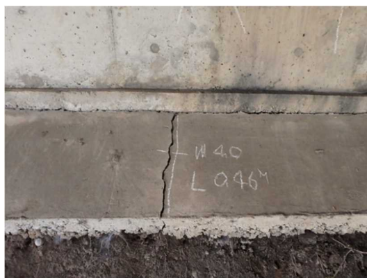
写真-2 橋台のひびわれ
