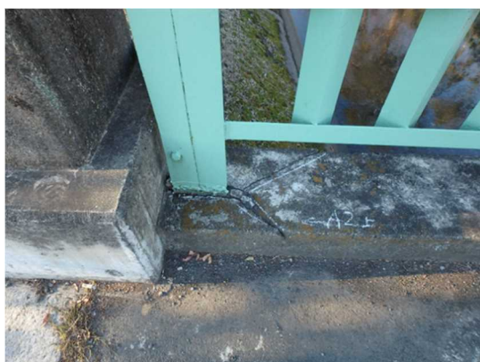
写真-5 地覆のひびわれ
