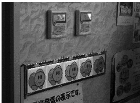
発電状況を示す屋内の発電状況表示システムは点灯、消灯が手動式になっており、器材のコスト削減のほか、デジタル表示器を頻繁に確認する必要があるため啓発効果が高い。
