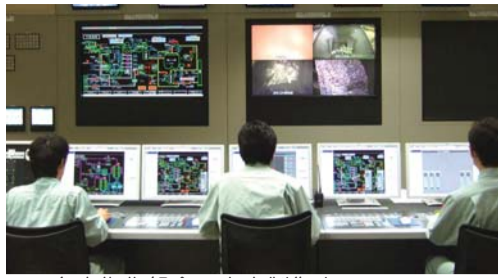
▲西多摩衛生組合の中央制御室
