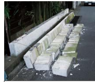
市内でブロック塀が倒壊
