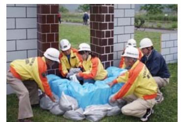
住宅浸水防止工法
